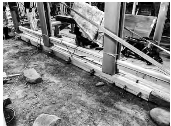
写真 3-5、土台矧木状況
