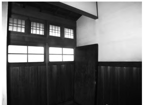
写真 2-14、風呂便所棟 風呂
