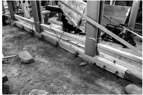
1、番頭部屋南面土台矧木
