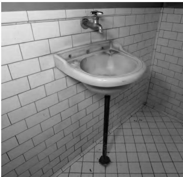
写真 2-11、便所前室手洗器
