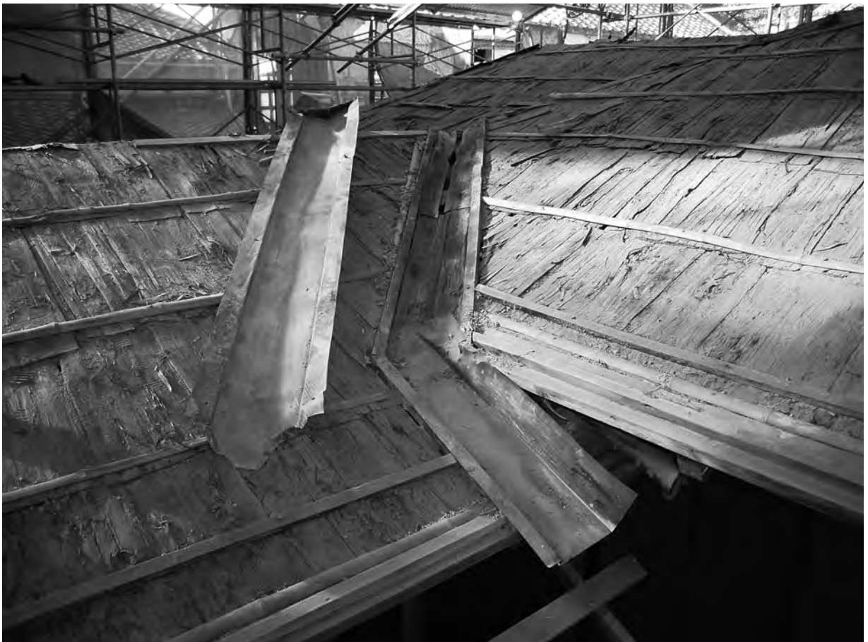
5、主屋部と南側突出部取合いの捨谷 12、土居葺
